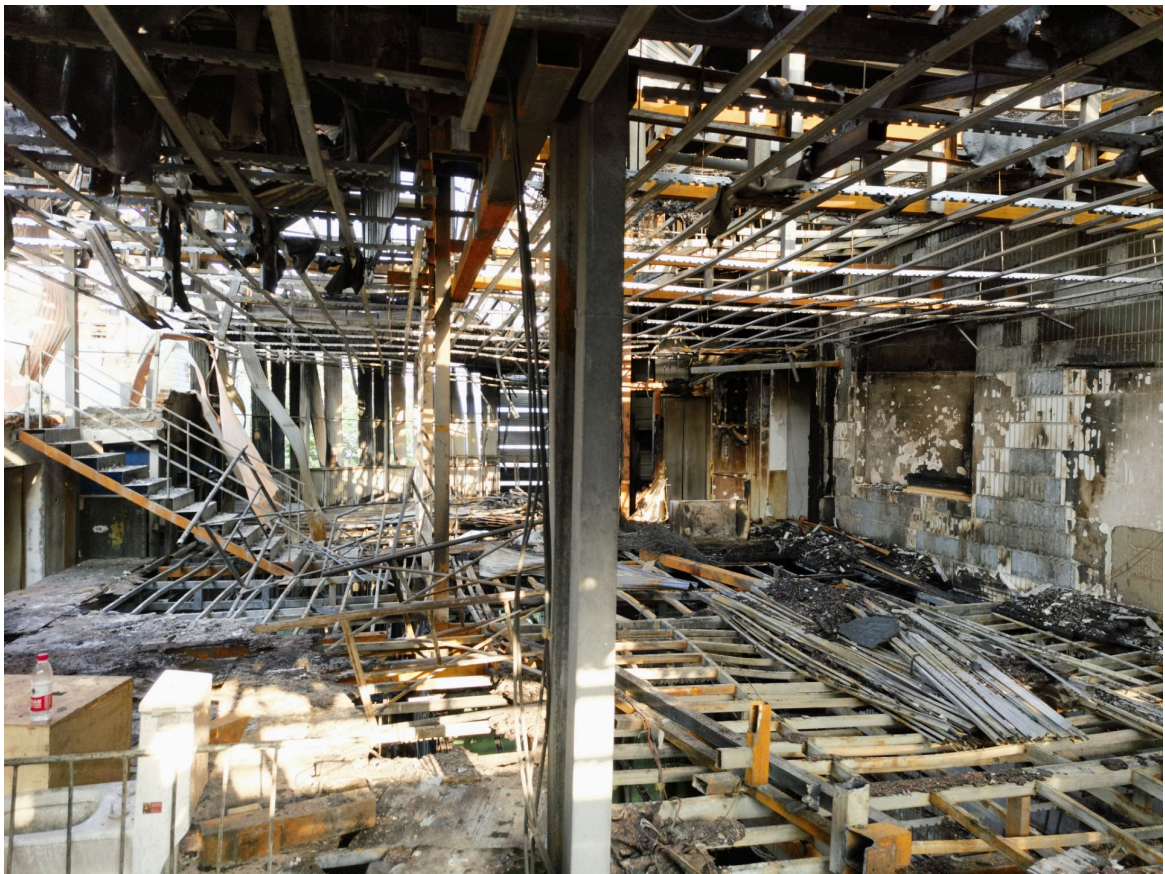
图2 事故建筑物钢箱梁连廊烧毁情况
