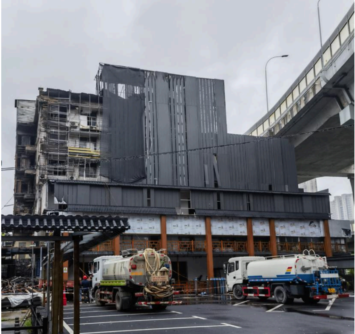
图1火灾后事故建筑物西侧外立面情况
